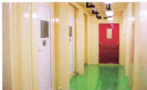
Módulo habitacional instalado na plataforma
